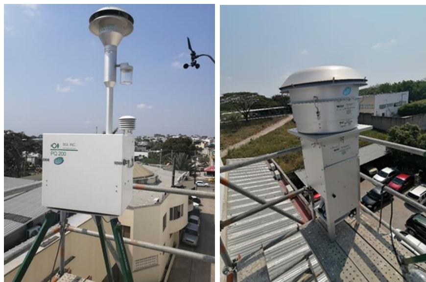
Ilustración 43. Estación de medición de calidad de aire, ubicada en sede principal de CARSUCRE Fuente: CARSUCRE
