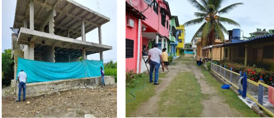
Ilustración 121. Visita de inspección técnica y ocular en atención al reporte de control y vigilancia N°14 del 27 de julio de 2022, con la finalidad de corroborar presuntas infracciones ambientales de tala de mangle, aterramiento y desvío de drenaje de aguas de escorrentías, en sector palo blanco, municipio Santiago de tolú.
