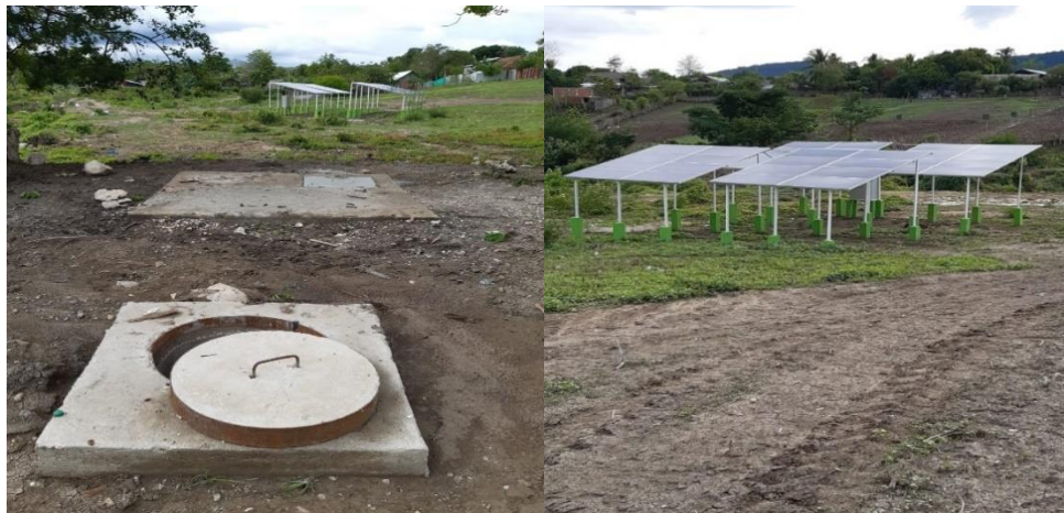
Estación de bombeo para las aguas residuales domésticas del sector Canta Rana y su sistema de suministro de energía a través de paneles solares.
