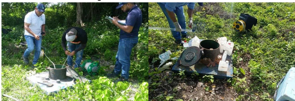
Ilustración 52. Mantenimiento piezómetro 52-II-B-PZ-01B: Fuente. Oficina de Aguas Subterráneas, 2025
