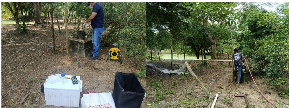
Ilustración 54. Mantenimiento piezómetro 52-II-C-PZ-01: Fuente. Oficina de Aguas Subterráneas, 2025
