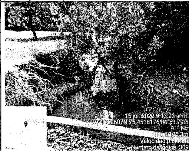
Imagen 4: Vista de la socavación con acción erosiva activa en la parte externa de los meandros y sedimentación en la parte interna. Cauce del arroyo Mochá, zona rural del municipio de Sampués
