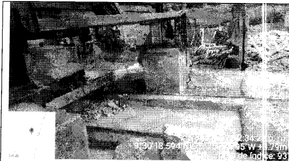
Imagen 9: Sistema de drenaje de aguas industriales de la zona de corte y procesamiento de material
